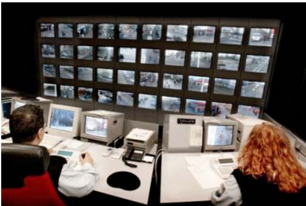
Figuur 9.3 Controlekamer cameratoezicht Rotterdam CS (bron: website gemeente Rotterdam Veilig)
