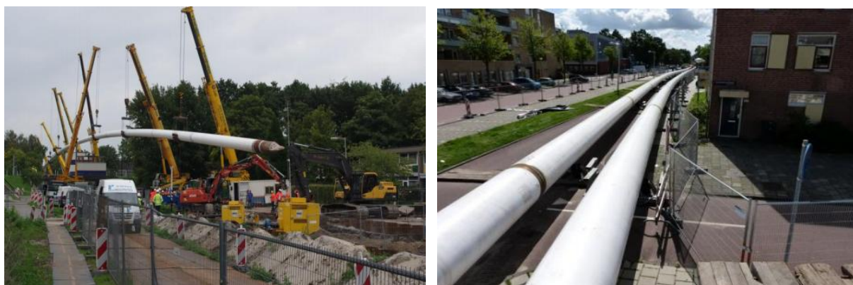
Figuur 9 Foto's verleggen kabels en leidingen over Karspeldreef en Kolfshotenstraat in 2014 (AGG, 2015)
