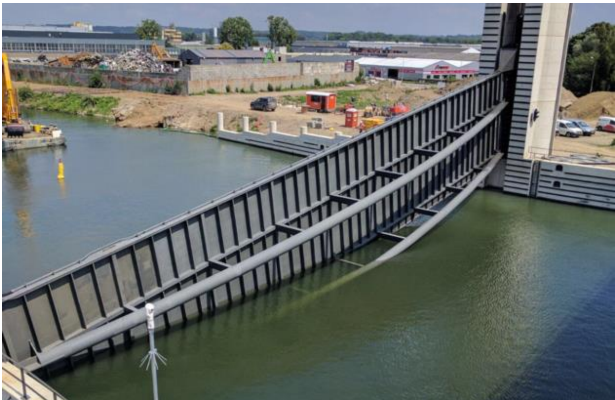
Figuur 6. Scheefzakken van de sluisdeur
